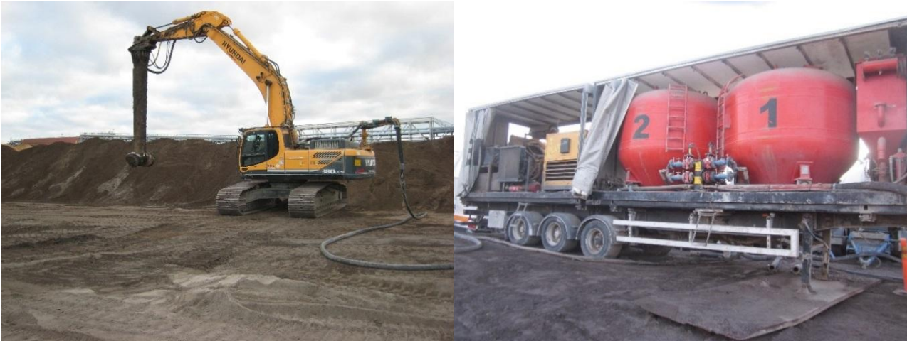
Kuvat 3 ja 4. Massastabilointikalusto: vasemmalla kaivinkone, jossa puomiin kiinnitetty sekoitin. Oikealla sideainesäiliöt sekä syöttöyksikkö.
